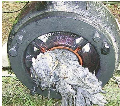
Pumpenverstopfung (Beispiel einer anderen Kläranlage)
